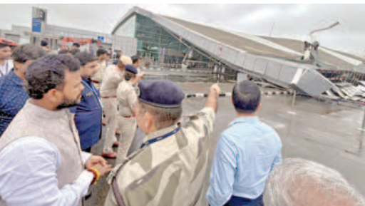
శుక్రవారం విమానాశ్రయం టెర్మినల్ వన్ లో కూలిన ఫైకప్పు పరిశీలిస్తున్న విమానయానశాఖమంత్రి రామేశ్వరన్ నాయుడు
